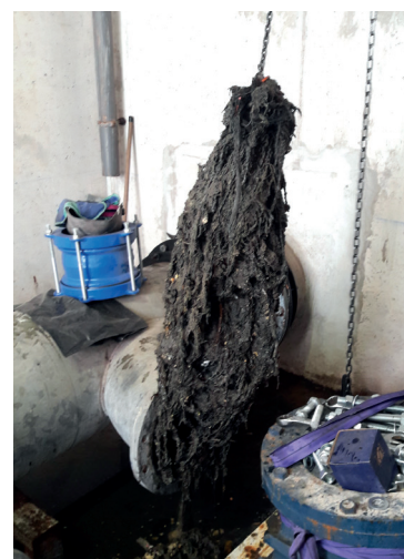
Les lingettes se retrouvent par paquet dans les conduites de refoulement (ici à Toul).
