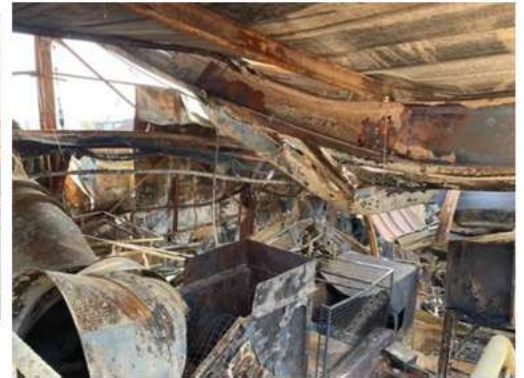
Etat de la chaîne de tri suite à l'incendie
